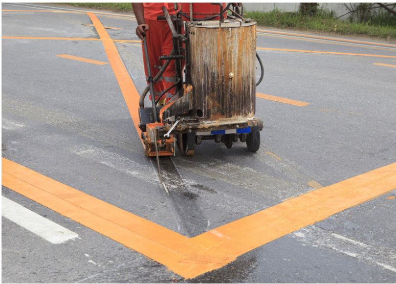
Nettoyage de matériels de dépose de peintures techniques, telles que peintures routières.
